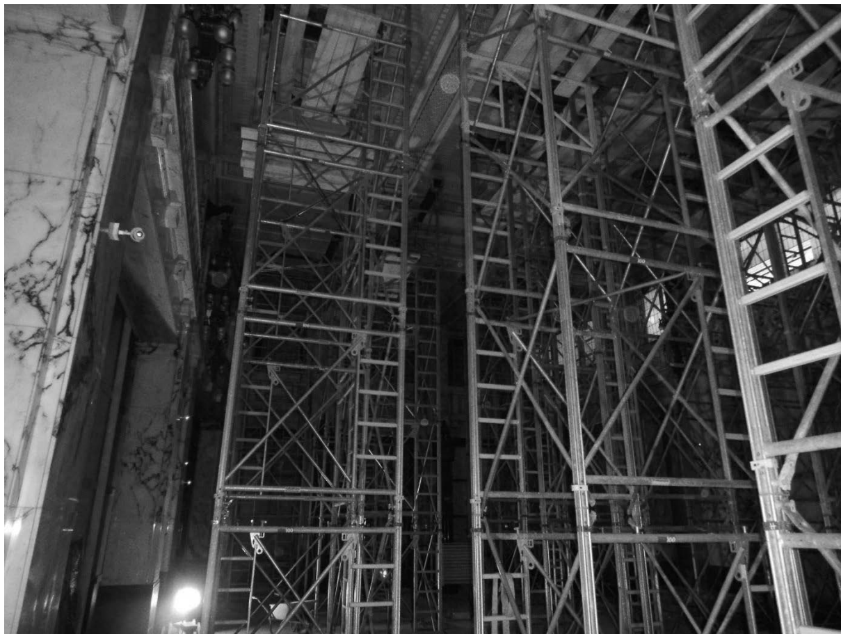
Abb. 10: Die Situation nach dem Brand vom 18.11.2011 im Kassensaal
